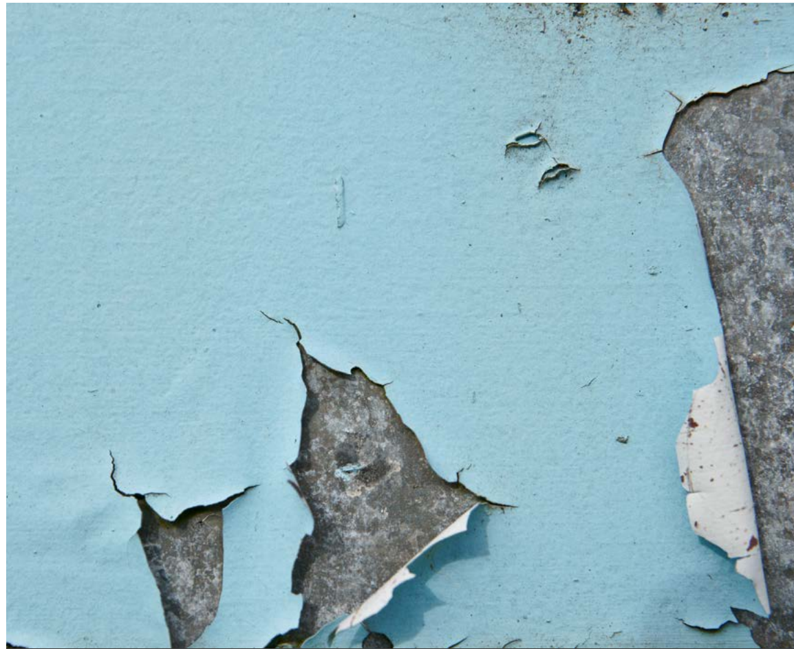
Check vooraf grondig de toestand van het metaal
