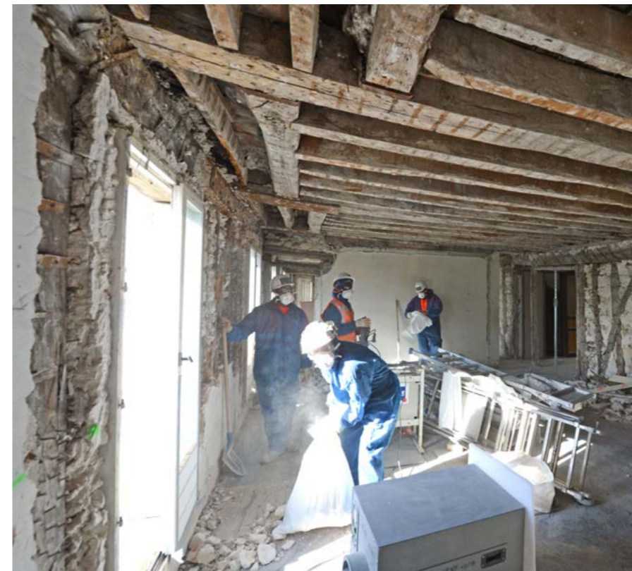
Dans les vieux bâtiments, on trouve encore de nombreux matériaux contenant de l'amiante non lié
