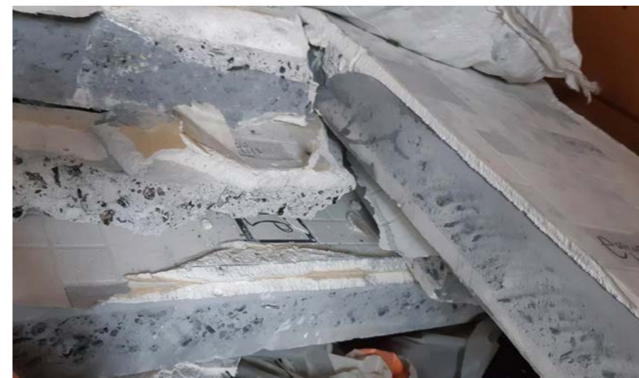
Amiante dans les déchets de construction
