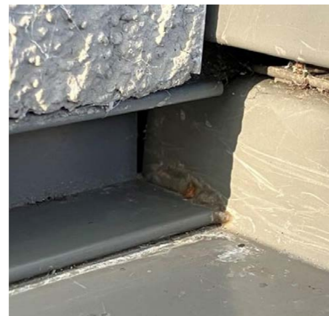
Xthermo - Détail d'un raccord non étanche à l'eau
