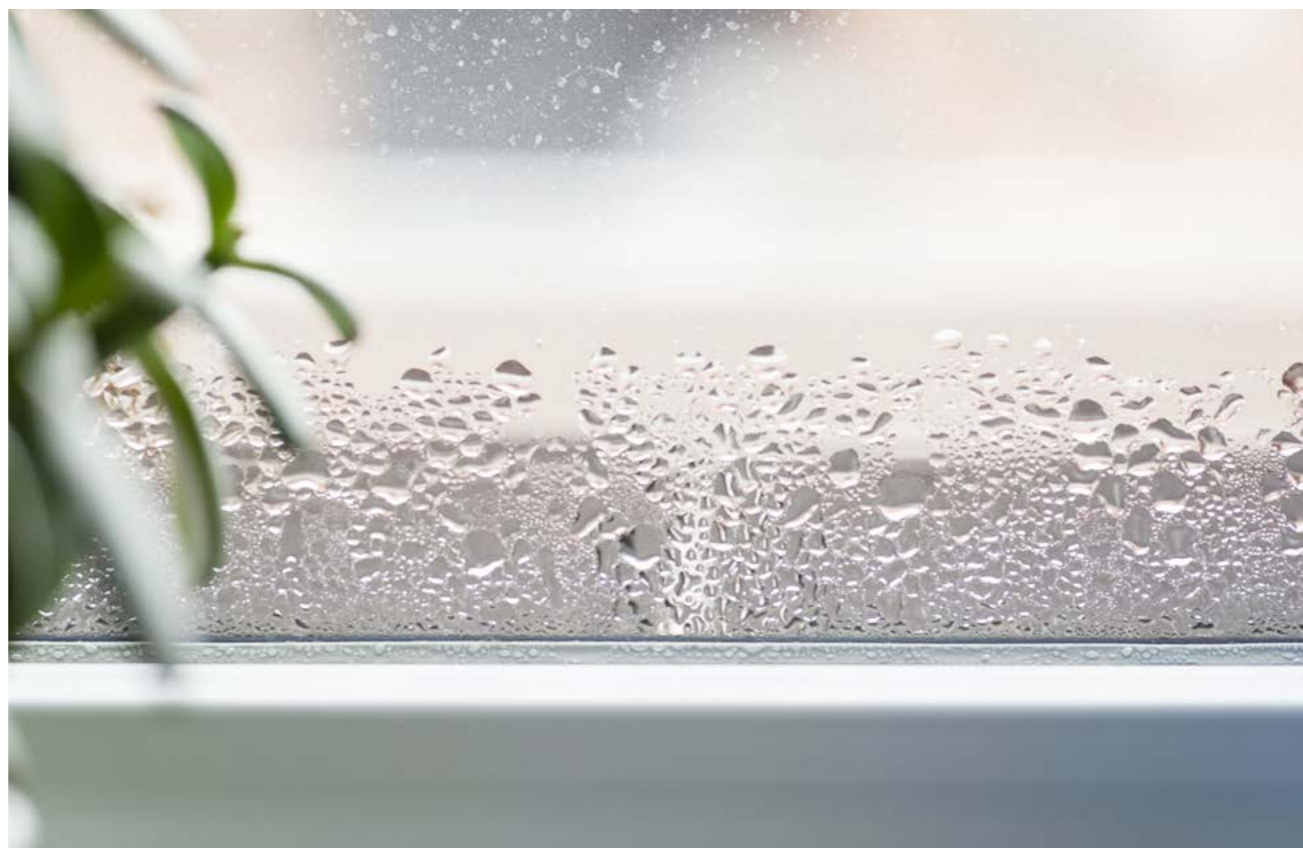
Wanneer condensatie het verfoppervlak aantast, raakt deze beschadigd
