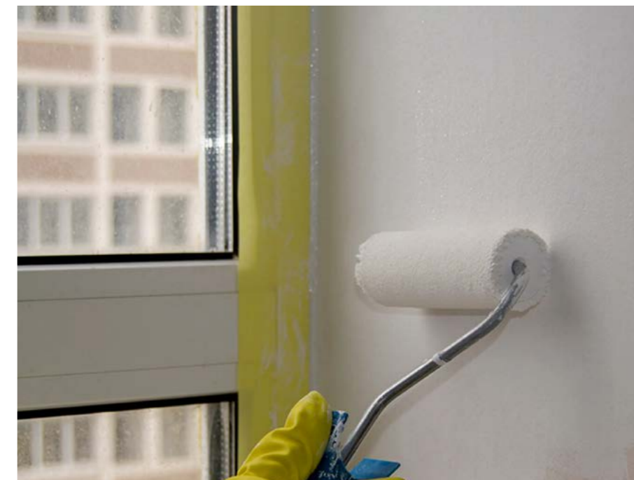
Wanneer condensatie het verfoppervlak aantast, raakt deze beschadigd
